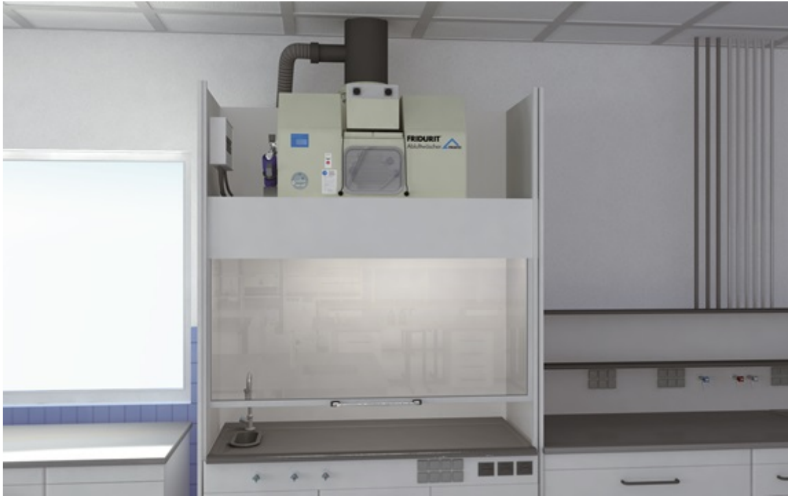
Zdj. Punktowa neutralizacja oparów z neutralizacją ścieków
