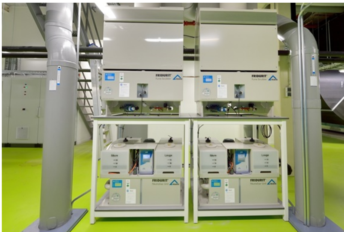
Zdj. Stacja neutralizacji oparów i ścieków
