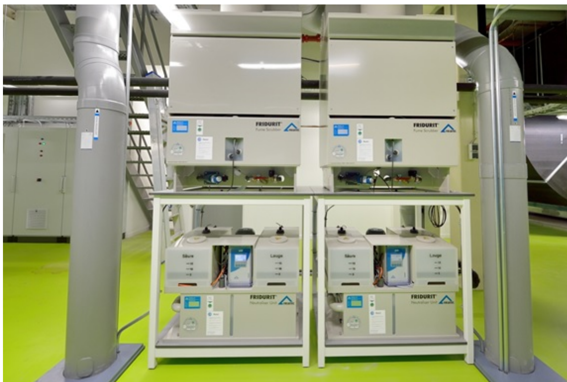
Zdj. Stacja neutralizacji oparów i ścieków
